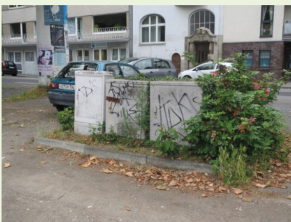
Verteilerkästen für Markt- und Kirmesnutzung
