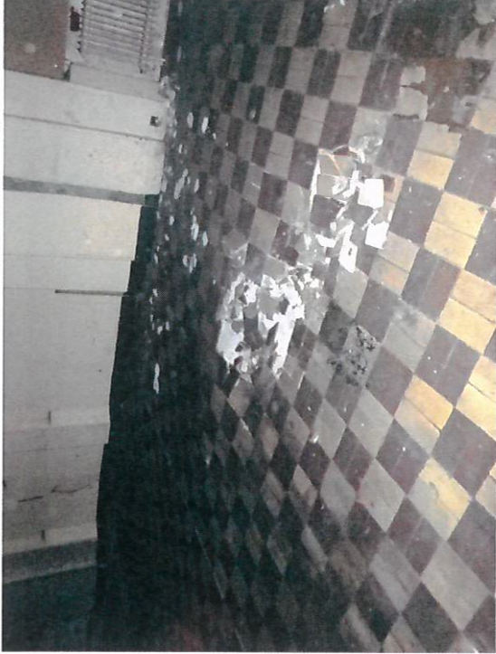
Foto 29: aufgewölbter Fußboden im Rohwarenlager
