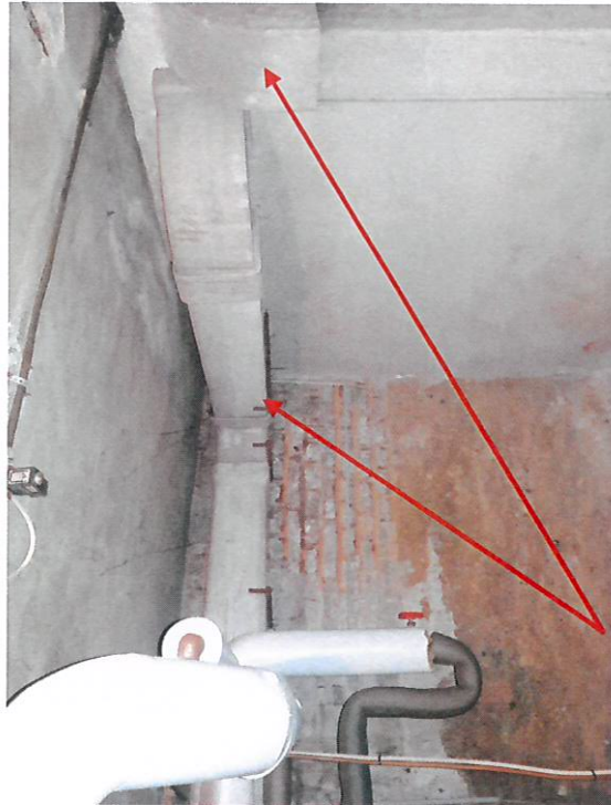
Foto 47: Toshi-Rohre im Heizungsraum des Kutscherhauses
