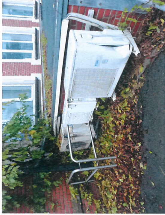
Foto 36: Klimageräte östlich vor der Villa
