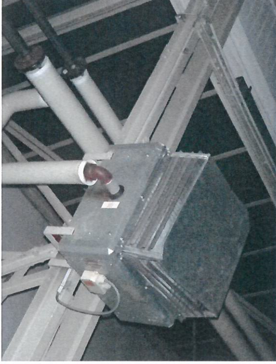
Foto 34: Heizgebläse unterhalb der Decke im Rohwarenlager
