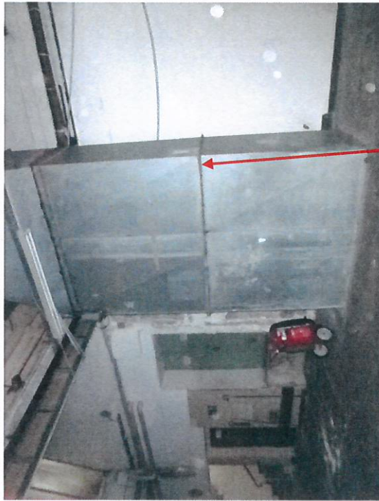
Foto 35: Lüftungskanal mit asbesthaltigem Kitt im Rohwarenlager
