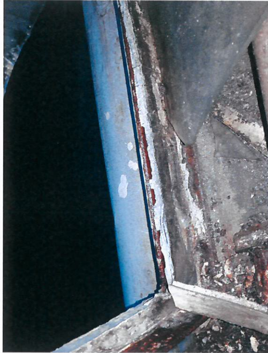
Foto 27: asbesthaltiger Fensterkitt (P 23) in Sprossenfenster
