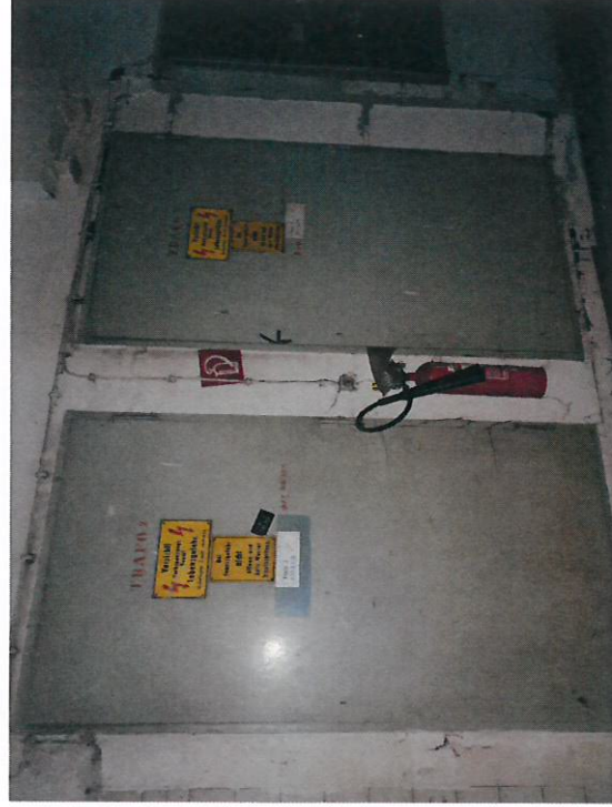
Foto 28: BS-Türen zu den Trafo-Räumen in der Schlosserei
