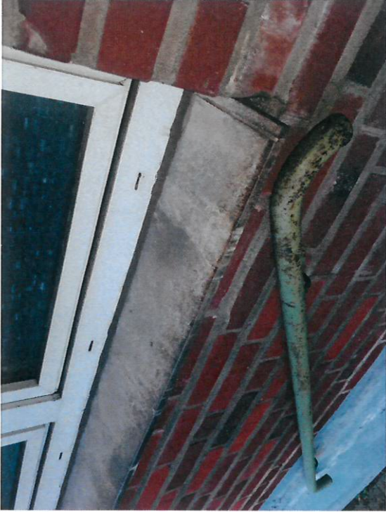
Foto 25: Asbesthaltiger Fensterkitt am Bürotrakt im SW
