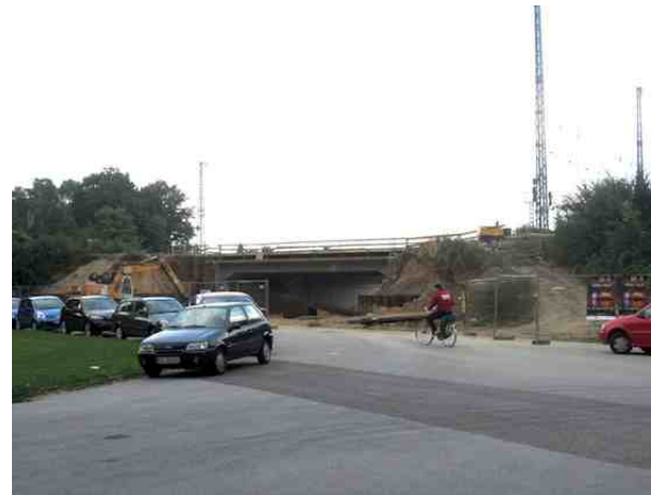
Kreuzungsbereich Eichenbusch - Bahnhofstraße/-platz südwestlich der Bahntrasse; in der Bildmitte die neue Bahnunterführung zur Brüsseler Allee (in Bau)
